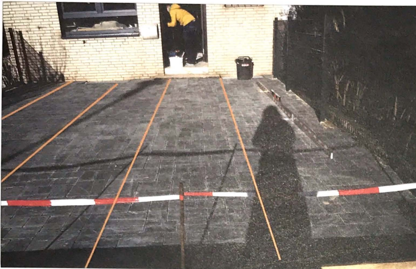
Bereits bei dieser kleinen Pflasterfläche wird deutlich, wie hoch das Fehlerpotenzial ist. Darunter etwa ein falscher Pflasterverband mit durchgehenden Linien – im Foto farblich hervorgehoben.
